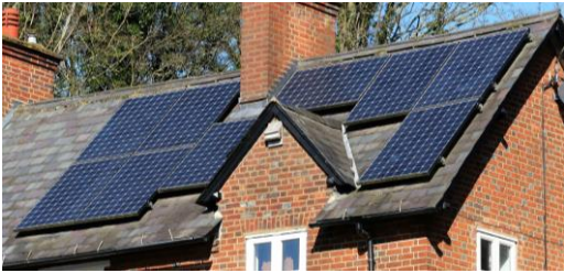
屋根に設置されたソーラーパネル
