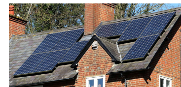
屋根に設置されたソーラーパネル
